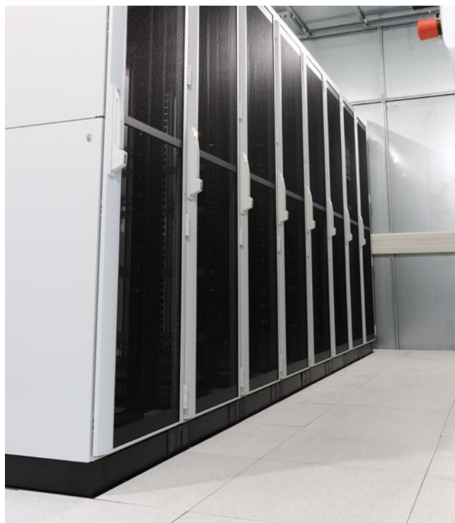
Verstärkerraum der neuen Halle
